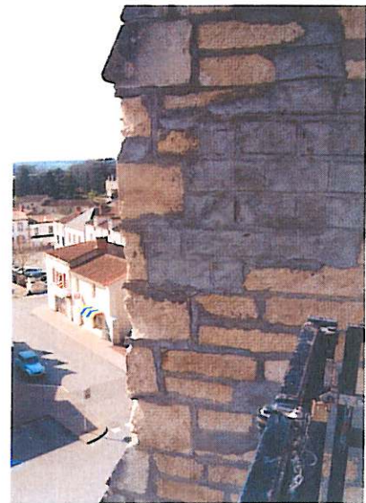
Dégradation des pierres calcaires & réparations anciennes au ciment
