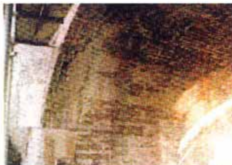
Dissesto della superficie di intradosso del ponte
