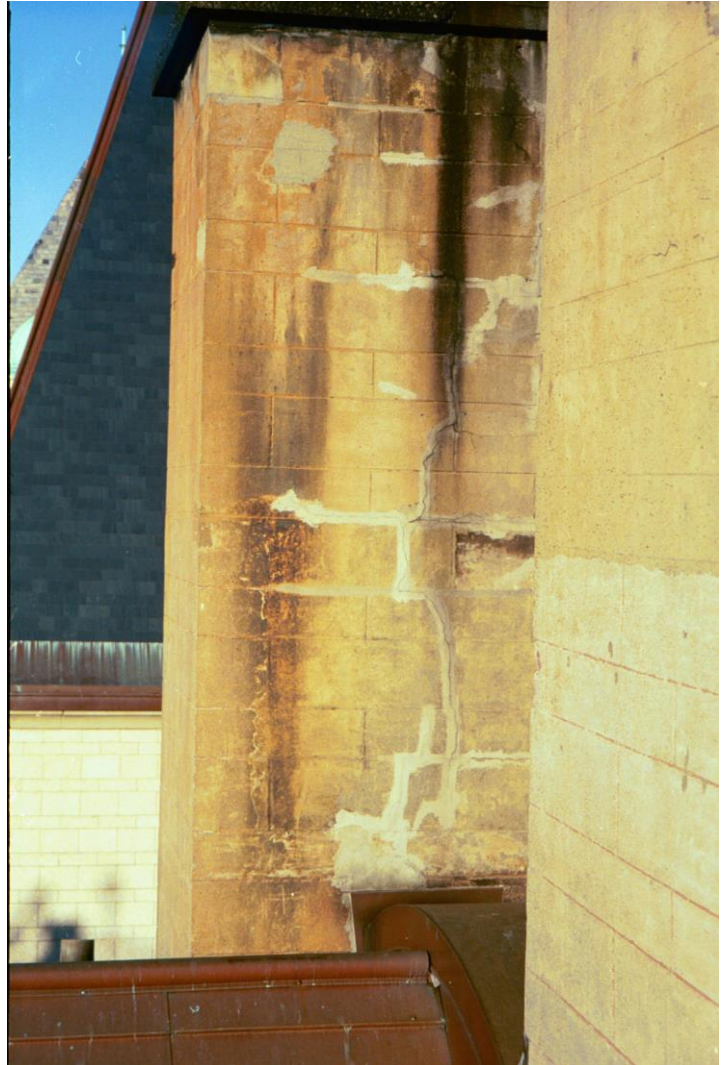
Défaillance due au rejointoiement du mortier dur
