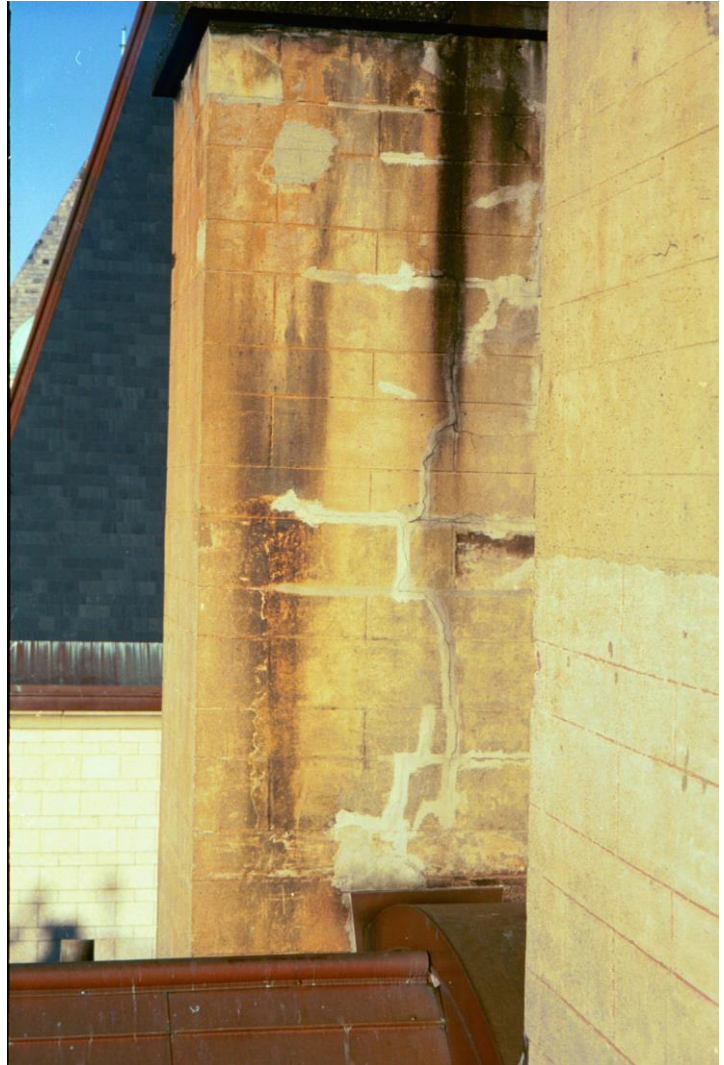
Défaillance due au rejointoiement du mortier dur
